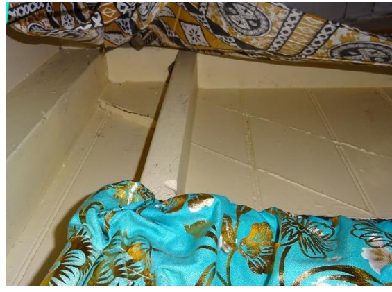
Fig.1-10 硬化したペンキにより撤去された筋交の形が残る
